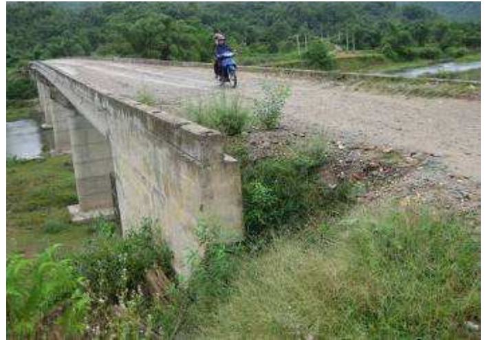
Mặt đường nối đầu cầu đang bị sụt xuống
