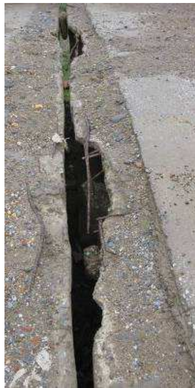
Mặt cầu đang bị vỡ ra
