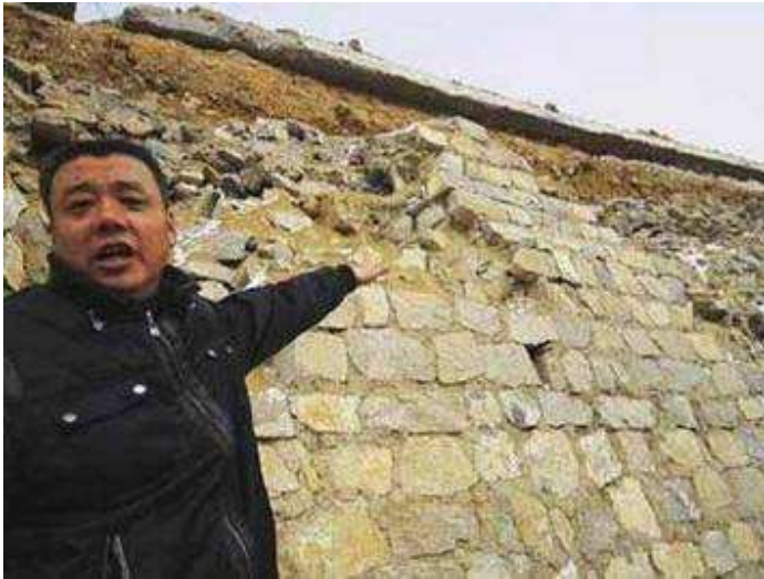
Bên ngoài công trình đường hầm huyện Bảo Đức đã bị sạt lở
